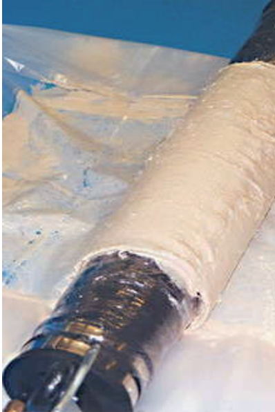
Eine mit Harz getränkte Glasfasermatte wird auf den Packer aufgerollt und danach in das zu sanierende Rohr eingebracht und aufgeblasen.
