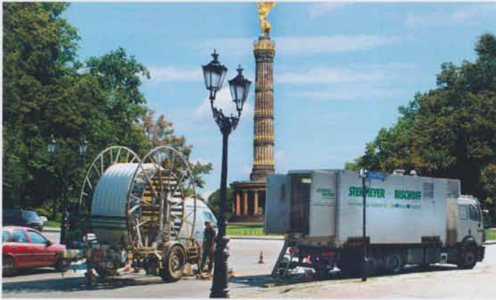
Von der Rolle: Das beim Compact-Pipe-System eingesetzte PE-Rohrsystem wird nach der Extrusion im Herstellerwerk vorverformt, um eine Querschnittsreduzierung zu realisieren. Die sogenannte C-Form erleichtert das Einziehen des Rohres in die Altleitung. | Foto: Wavin GmbH
